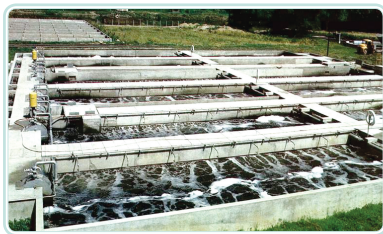
Figura 3.14: Reatores (tanques de aeração) de um sistema de lodos ativados
