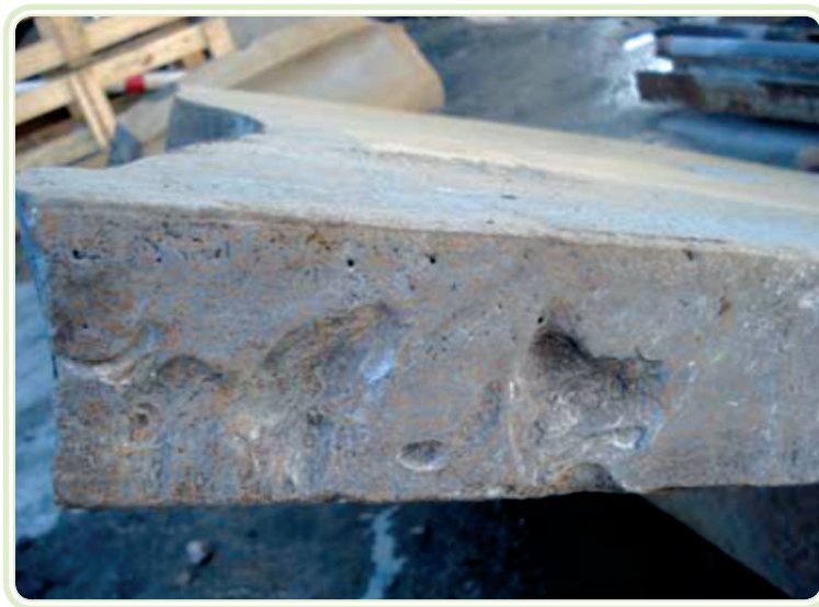
Figura 9.9: Cavidades superficiais na extremidade da peça em regiões de início das trincas, observadas nos pedaços da peça quebrada
