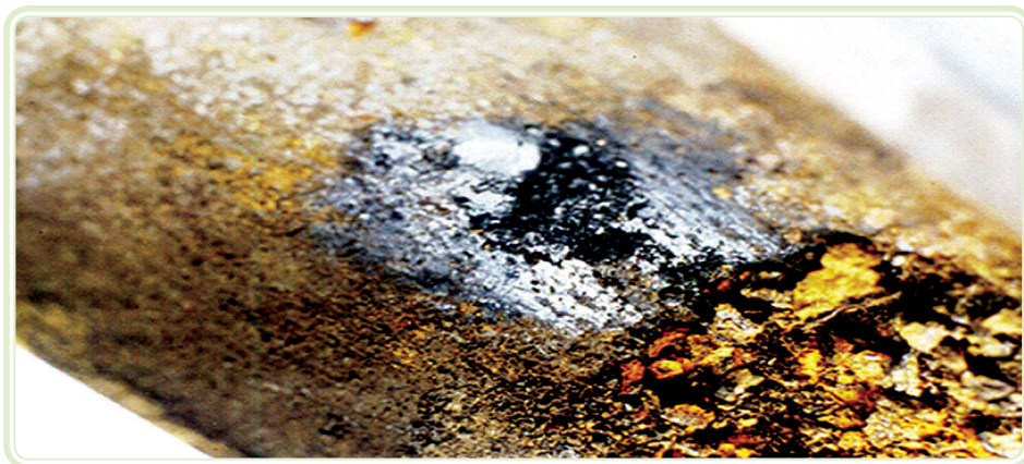
Figura 1.13: Retirada das incrustações e evidência da corrosão grafítica: parte escura da fotografia
