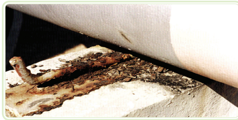
Figura 1.18: Corrosão no apoio de tubulação
