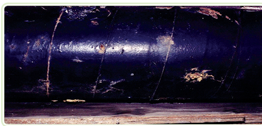
Figura 1.17: Falhas no revestimento com fita plástica e perfuração na tubulação
