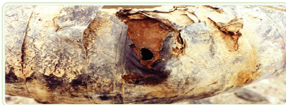
Figura 1.16: Exemplo de falhas no revestimento aplicado na superfície metálica com fita plástica e perfuração na tubulação
