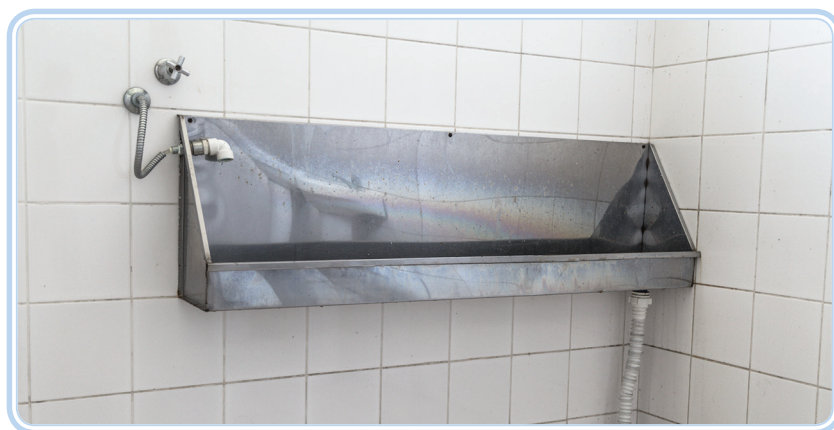
Figura 5.2: Mictório tipo calha, de aço inoxidável
