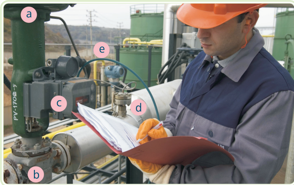
Figura 7.2: Válvula de controle instalada: (a) atuador pneumático; (b) elemento obturador; (c) transmissor; (d) sensor e (e) ar comprimido Fonte: www.emersonprocess.com
