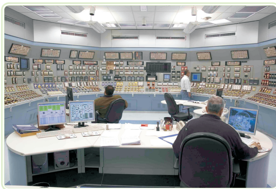
Figura 1.2: Sala de controle da usina nuclear de Angra dos Reis
