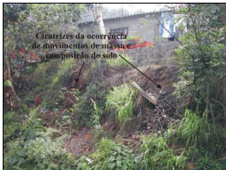
Figura 3: situação de risco junto ao corte da ferrovia
