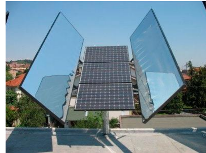
Fig. 3. Módulo espelhado com estrutura de rastreamento.
