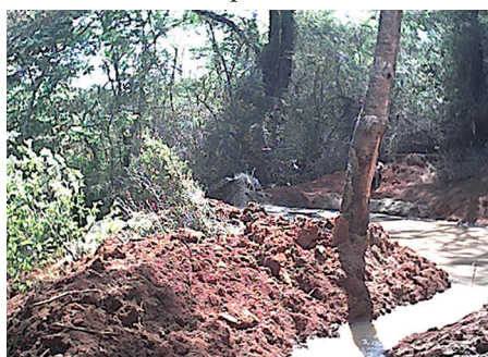
Figura 21. Água da dragagem retornando para o leito do rio, provocando erosões e carreamento do solo.
