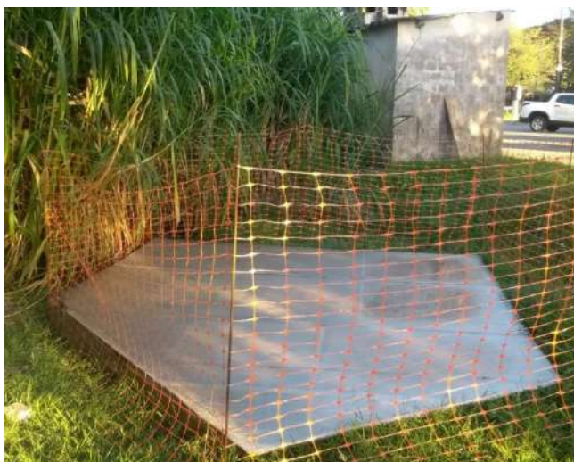
FOTO 07: Caixa separadora de água e óleo (CSAO)
