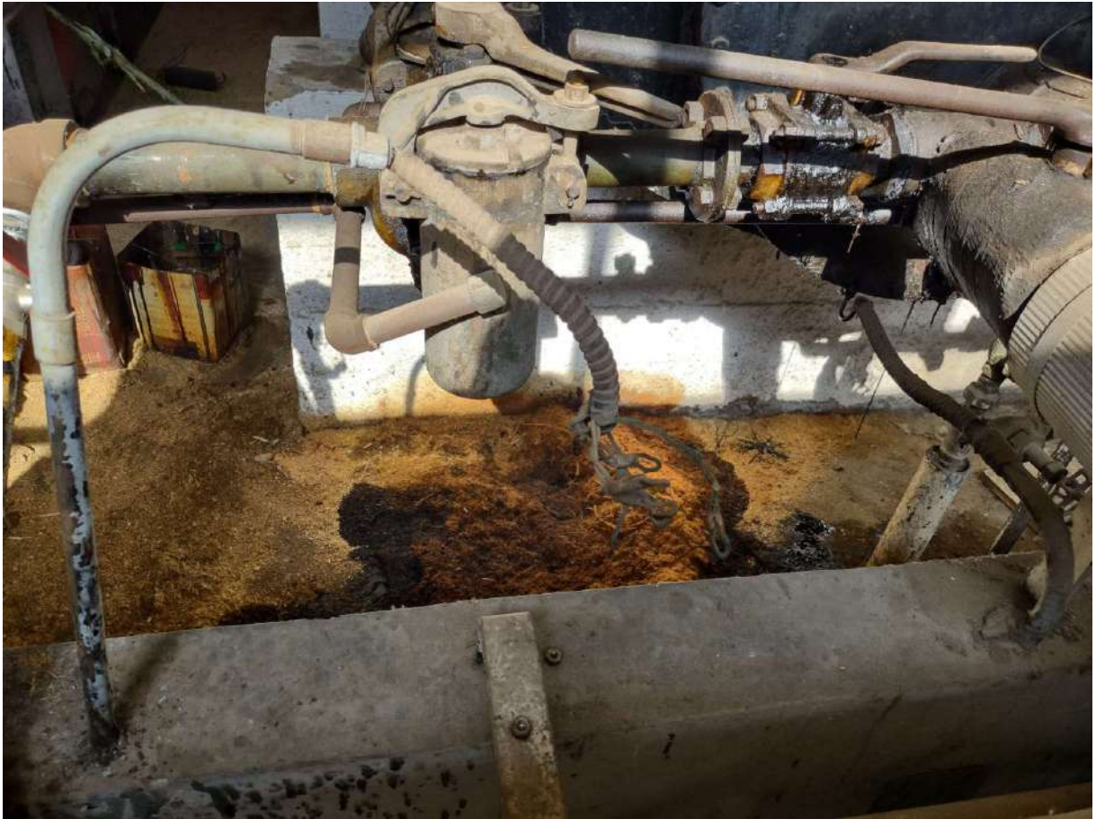
Figura 11 - Vazamento de combustível, contido de forma improvisada com serragem, dentro da área de armazenamento de combustíveis do HUSM.
