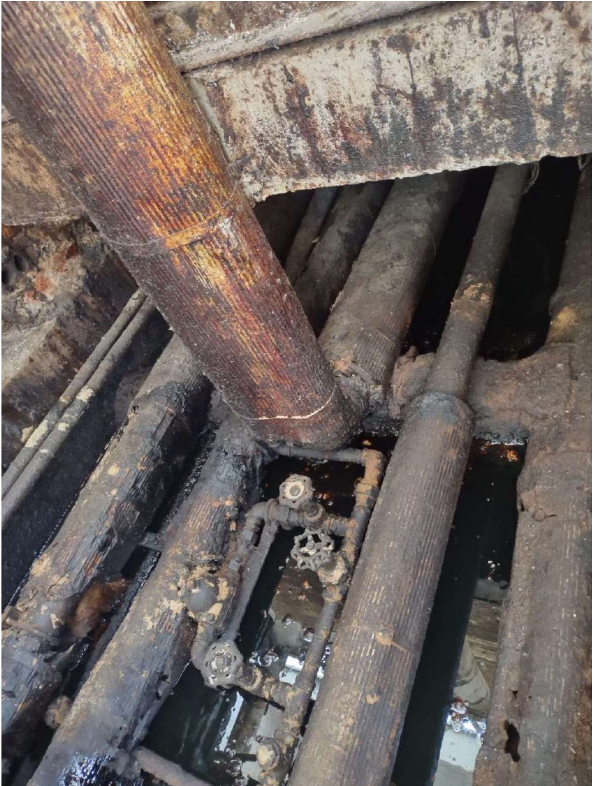
Figura 2 – Detalhes de derramamento de combustível na área interna do armazenamento de combustíveis do HUSM.
