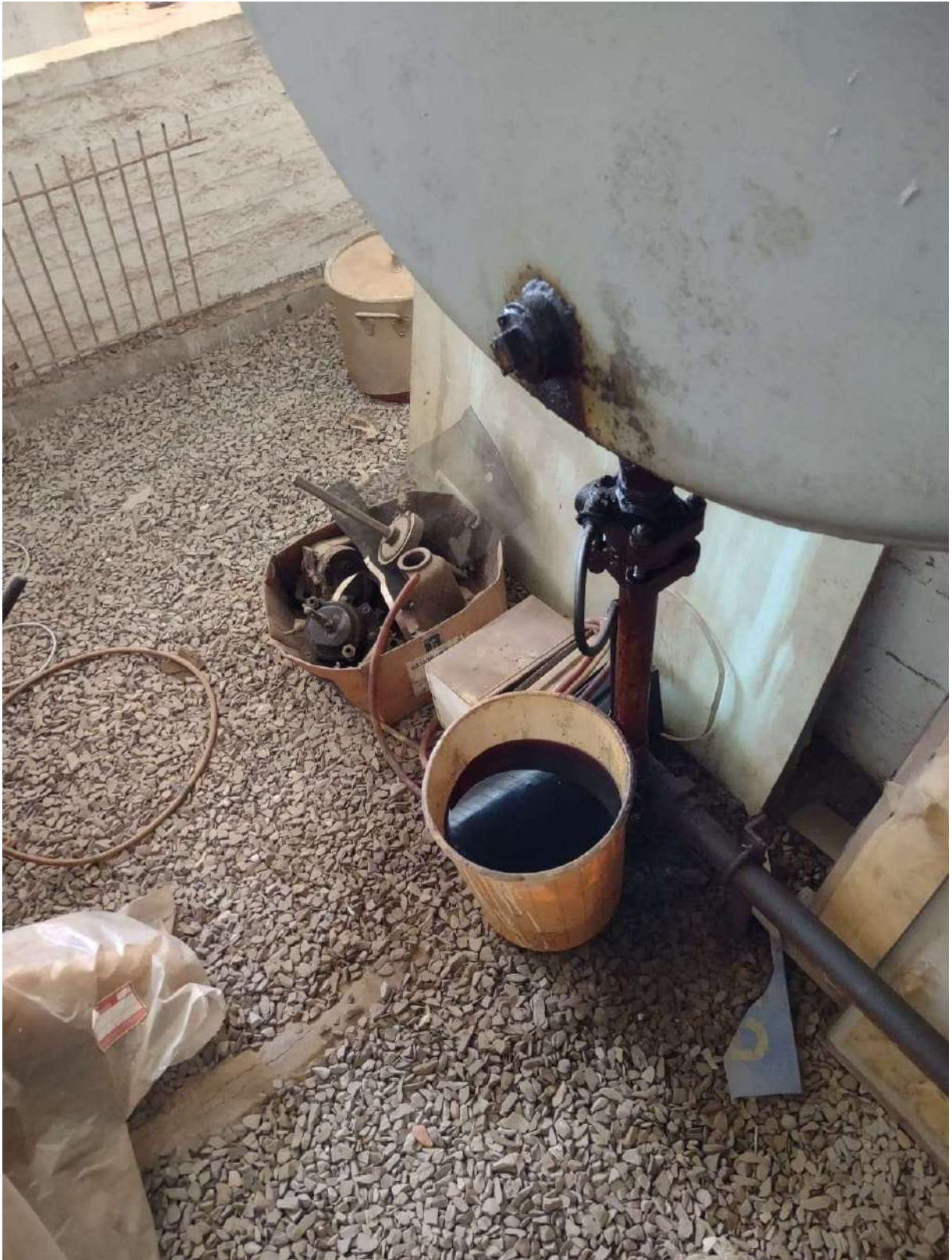
Figura 9 – Vazamento de combustível, contido de forma improvisada, dentro da área de armazenamento de combustíveis do RU.
