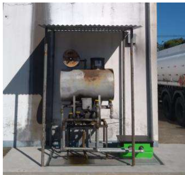
FOTO 08: Filtro de diesel do empreendimento
