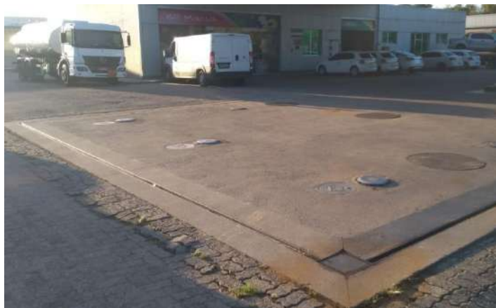
FOTO 02: Área de tancagem subterrânea do empreendimento
