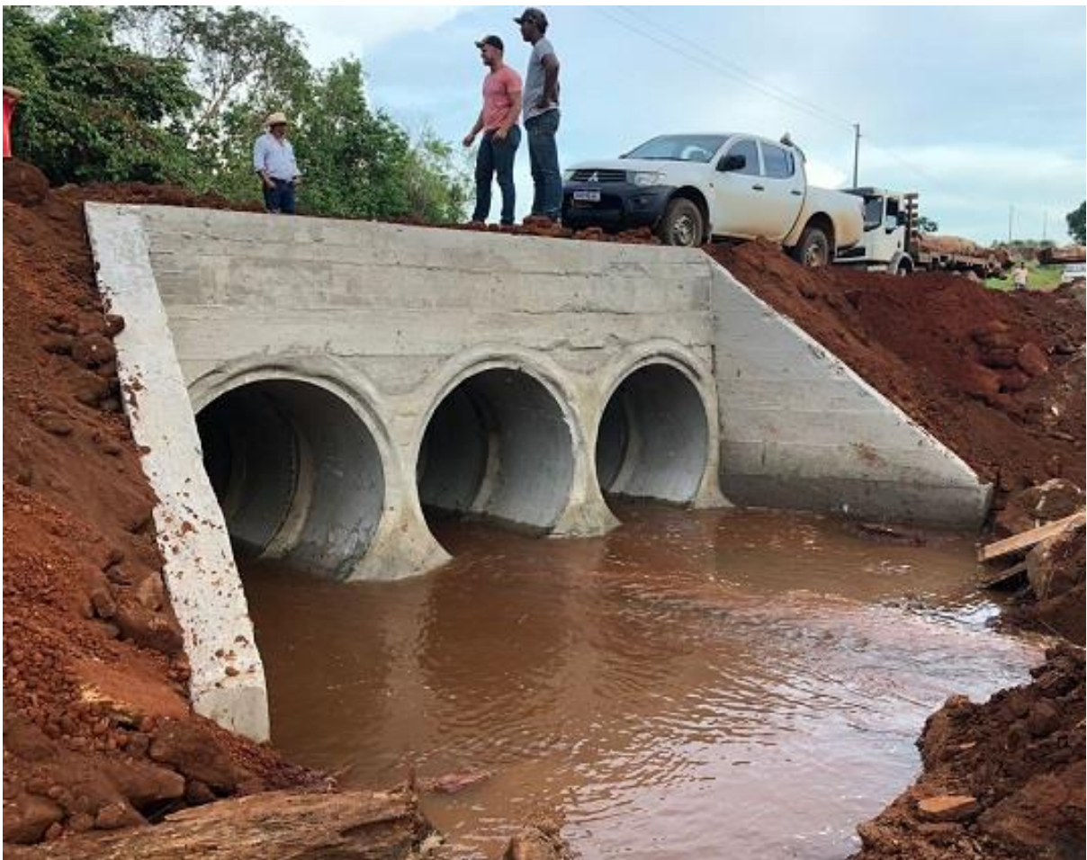
Figura 61: Bueiro com recobrimento insuficiente.
